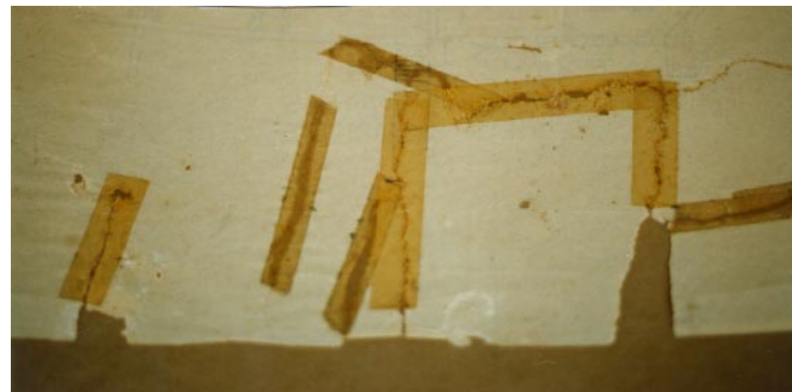
imagem 8 - Intervenções inadequadas: fita adesiva
