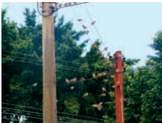
Bando de pardais em fiação da rede elétrica.
