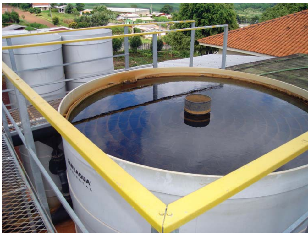
Filtros da ETA - Porto Barreiro, PR FOTO Marcelo Stedele | Banco de Imagens Cobrape
