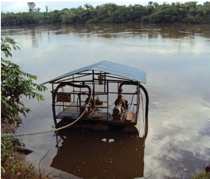
Captação de água - Pedro Afonso, TO FOTO Antônia Lima | Banco de Imagens Cobrape
