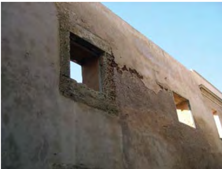
Fig.1.21 – Problemas de umidade acelerados por uso excessivo do cimento e contaminações de sais e compostos orgânicos, Essaouira, El Jadida, Marrocos.
