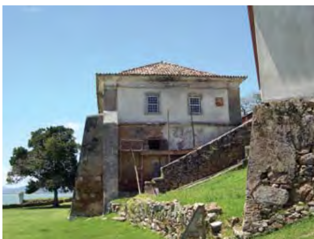
Fig. 3.24 – Aplicação de reboco, parede teste, Quartel da Tropa, Fortaleza de S.Cruz, SC.
