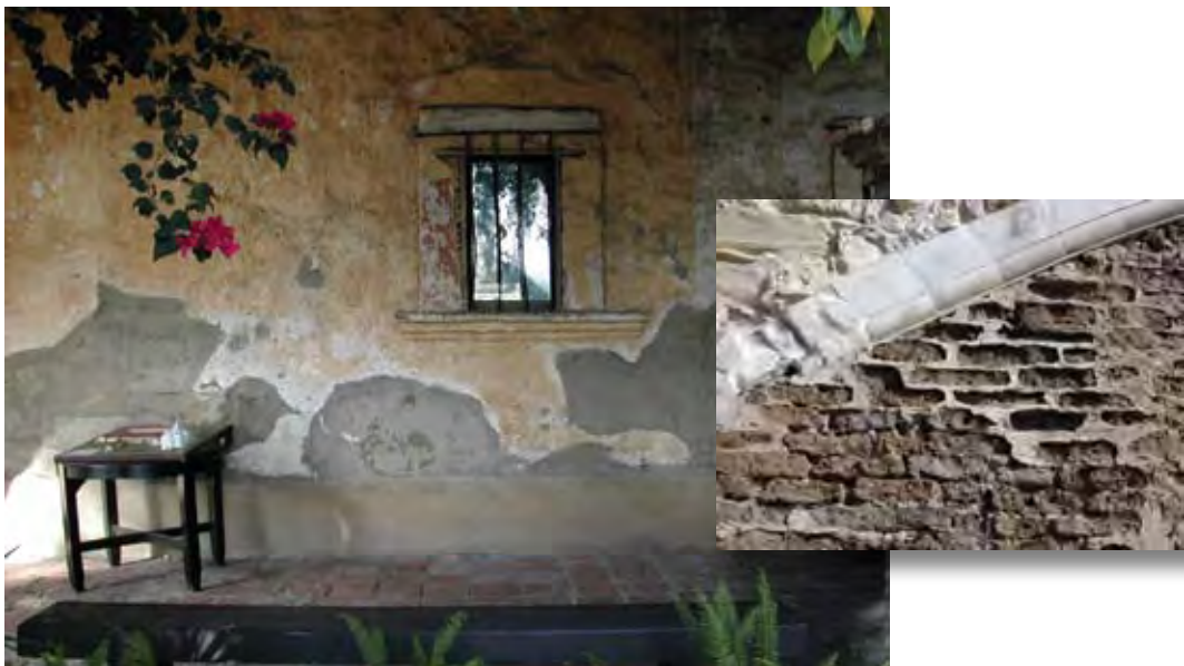
Fig. 1.19 – Intervenções com argamassas impermeáveis: degradação do reboco de cal acima e dos adobes. São Capistrano, EUA.
