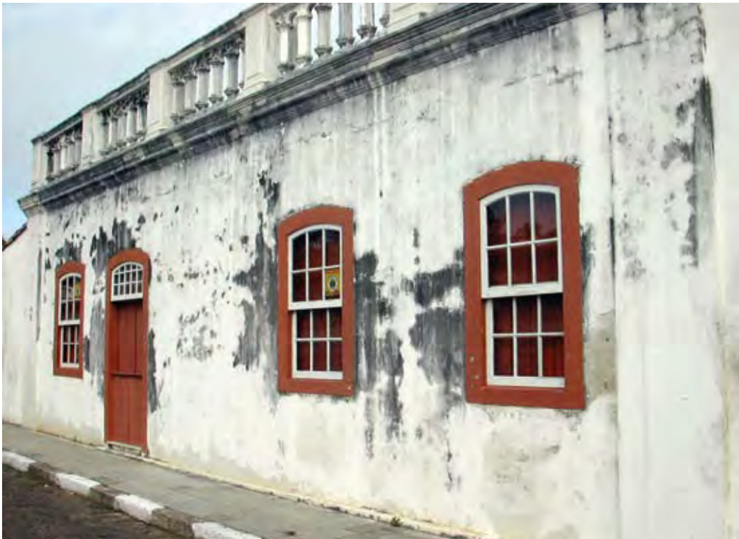
Fig. 4.14 – Excesso de aditivo pode resultar em problemas de biodeterioração. Casa Candemil, Laguna.
