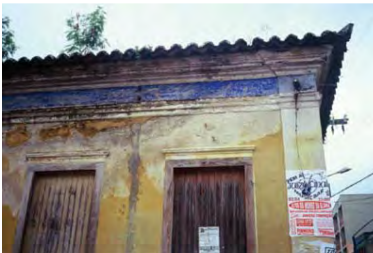
Fig. 4.19 – Intervenções sem conservar os acabamentos com argamassas pigmentadas originais nas cores azul, vermelho e amarelo. Laguna, SC.
