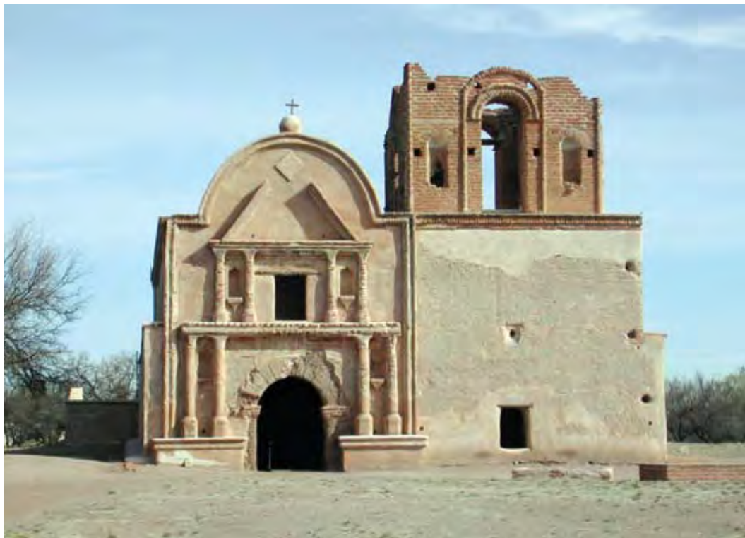
Fig. 1.15 – Intervenções de conservação e reparação de lacunas e fissuras, Tumacacori, Tucson, EUA.
