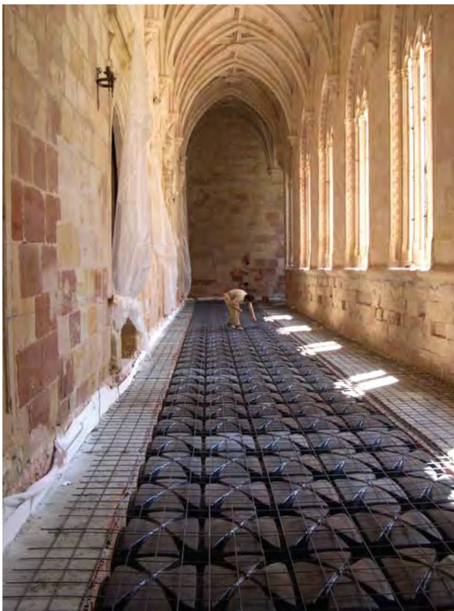
Fig. 1.25 – Câmaras de aeração para diminuir a umidade ascendente e os efeitos dos sais. Catedral de Sigüenza, Espanha.
