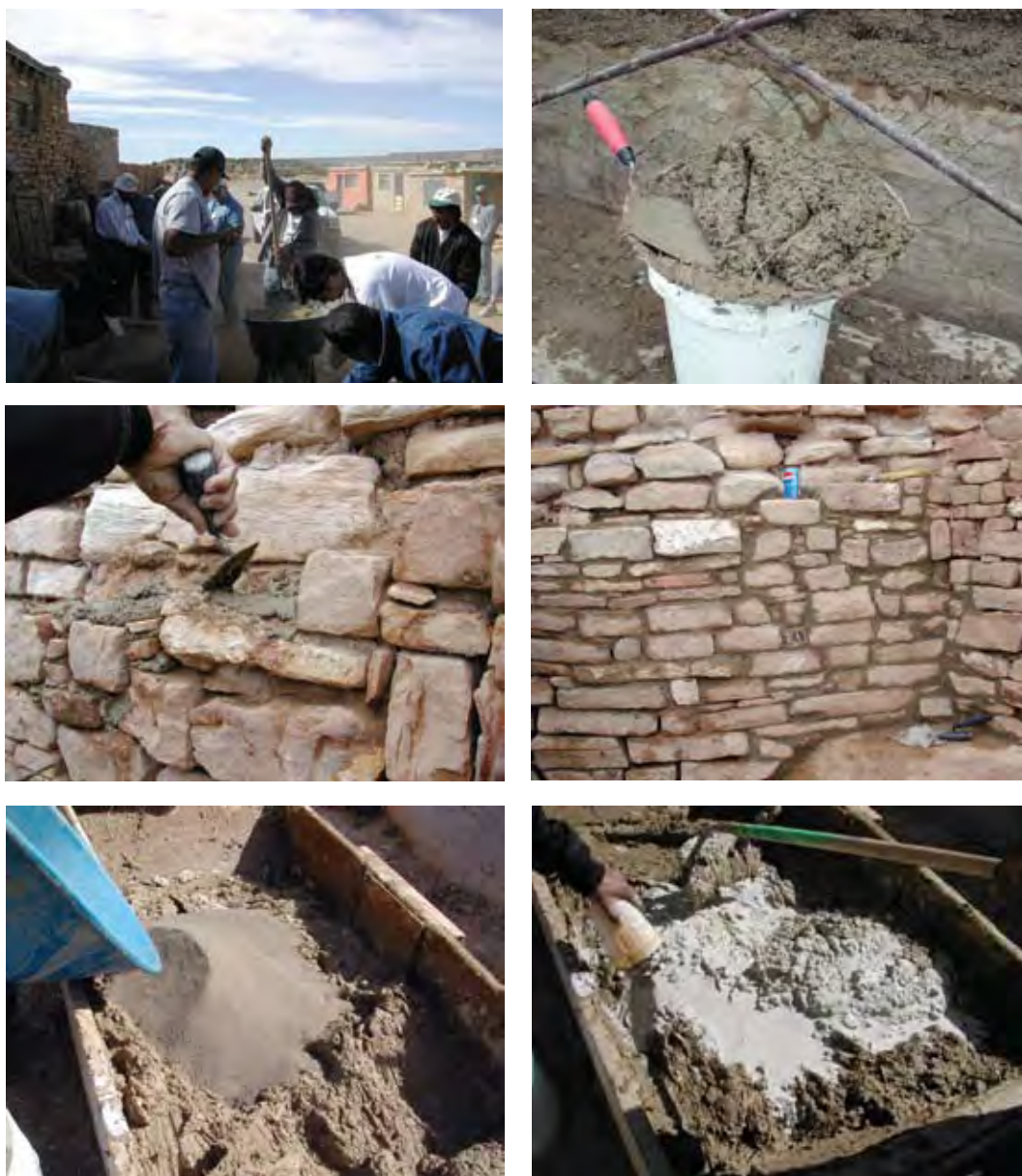
Fig. 3.14 – Reintegrações de muros de arenito. Argamassas de argila, areia, cal e fibras. Acoma City, EUA.
