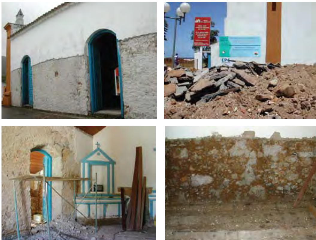
Fig. 1.20 – Intervenções com cimento, problemas de umidade e alteração estética, Ig. S. Sebastião, SC.
