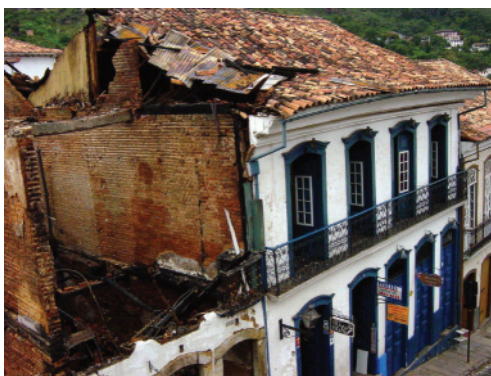
Figura 3.4 - Insuficiência de isolamento entre edificações.
