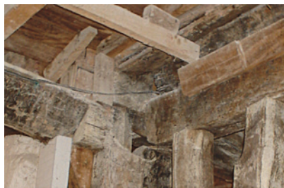
Figura 3.6 - Precárias condições de estabilidade estrutural.
