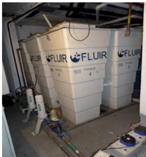
Figura 2 Estação de Tratamento de Águas Cinzas
