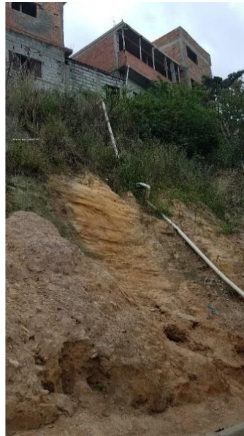
Fotografia 2 - Área de risco em Franco da Rocha
