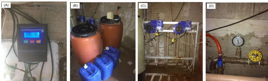
Figura 1. (A) Controle inteligente da bomba elétrica do poço tubular profundo; (B) tanques com hipoclorito de sódio (cor laranja, a esquerda) e com sulfato de alumínio e óxido de cálcio (cor laranja, a direita) com seu agitador por hélice (dispositivo de cor bege localizado na parte superior do tanque); (C) bombas dosadoras dos concentrados químicos e, ao fundo, o turbilhoador com ângulos de 90^\circ e (D) manômetro para controle de pressão da água bombeada do poço tubular profundo.
