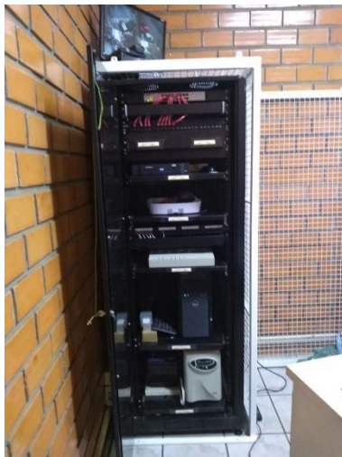
Figura 09 - Vista geral do Rack montado.
