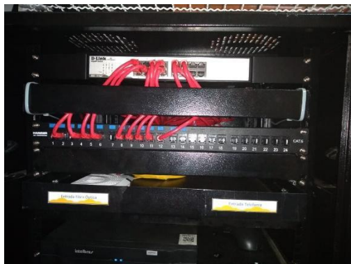
Figura 10 - Detalhe do Switch e patch panel.
