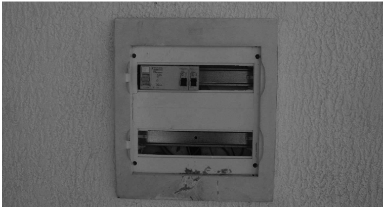
Figura 48 – Equipamento interno deprecado na área de lazer no Condomínio Terra Nova, em São Carlos
