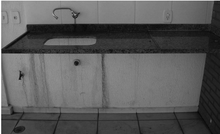
Figura 47 – Detalhe da pia, da cuba e do sifão quebrados no quiosque do Condomínio Terra Nova São Carlos, em São Carlos
