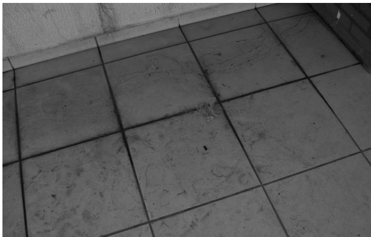
Figura 49 – Pisos encardidos no quiosque da área de lazer no Condomínio Terra Nova São Carlos, em São Carlos
