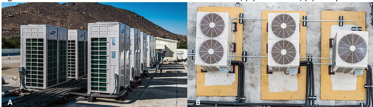
Figura 76 – Unidades condensadoras instaladas em locais abertos, (A) vista lateral, (B) vista por cima
