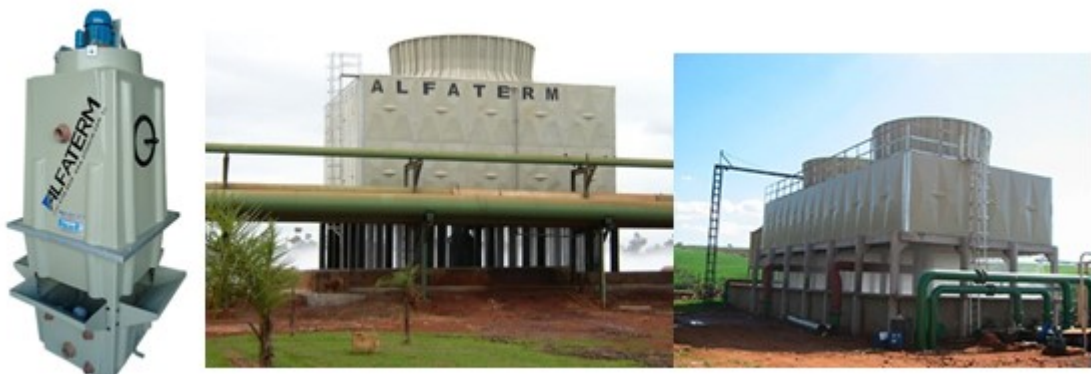
Figura 83– Torres de resfriamento com circulação forçada de ar
