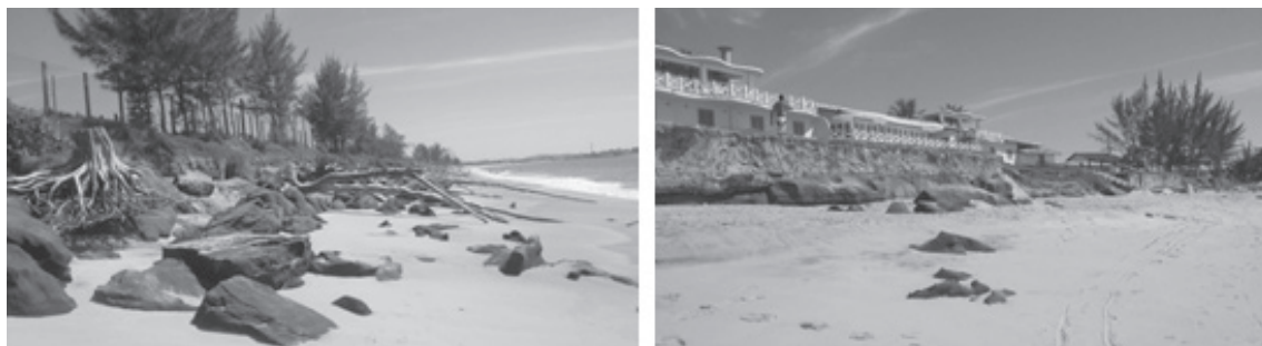
Figura 1. Processos erosivos na linha da costa desmatando e destruindo as edificações: Rio das Ostras
