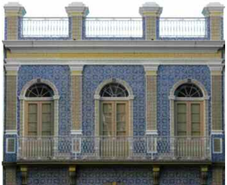
Abaixo. ANDAR SUPERIOR DE SOBRADO COM FACHADA REVESTIDA EM AZULEJOS, platibanda com gradil de ferro. Construído na década de 1870 no centro histórico de Porto Alegre (RS).
