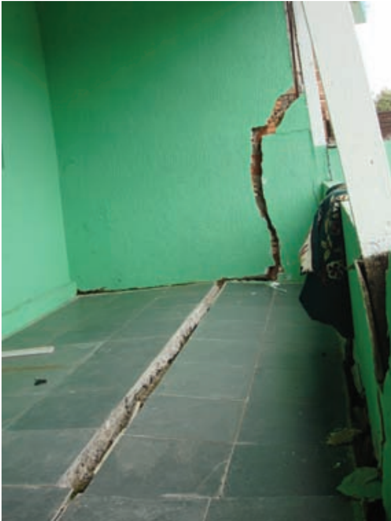
Trinca em área externa de moradia em Guaratinguetá (Janeiro de 2010). Foto: Acervo IG.
