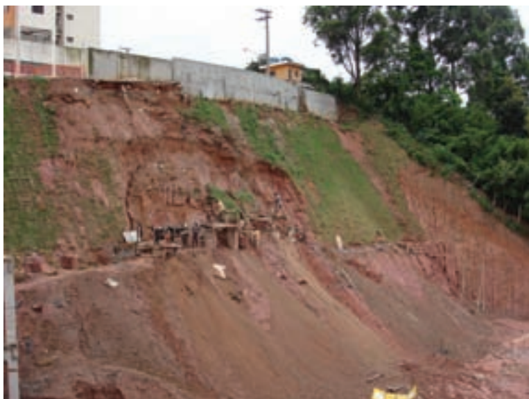
Intervenção antrópica em encosta no Taboão da Serra acentuando a declividade e causando escorregamento (Setembro de 2009). Foto: Acervo IG.
