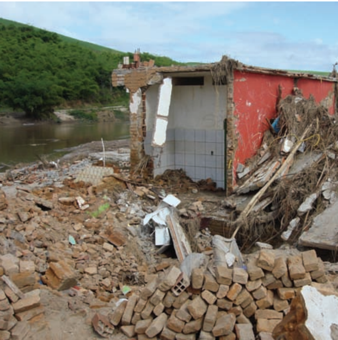
Moradia atingida por inundação em Branquinha (AL). Foto: Acervo IG
