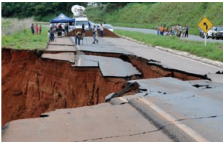
Escorregamento rotacional no km 24 da BR-060 (dezembro 2010). Foto: Valter Campanato - Agencia Brasil.
