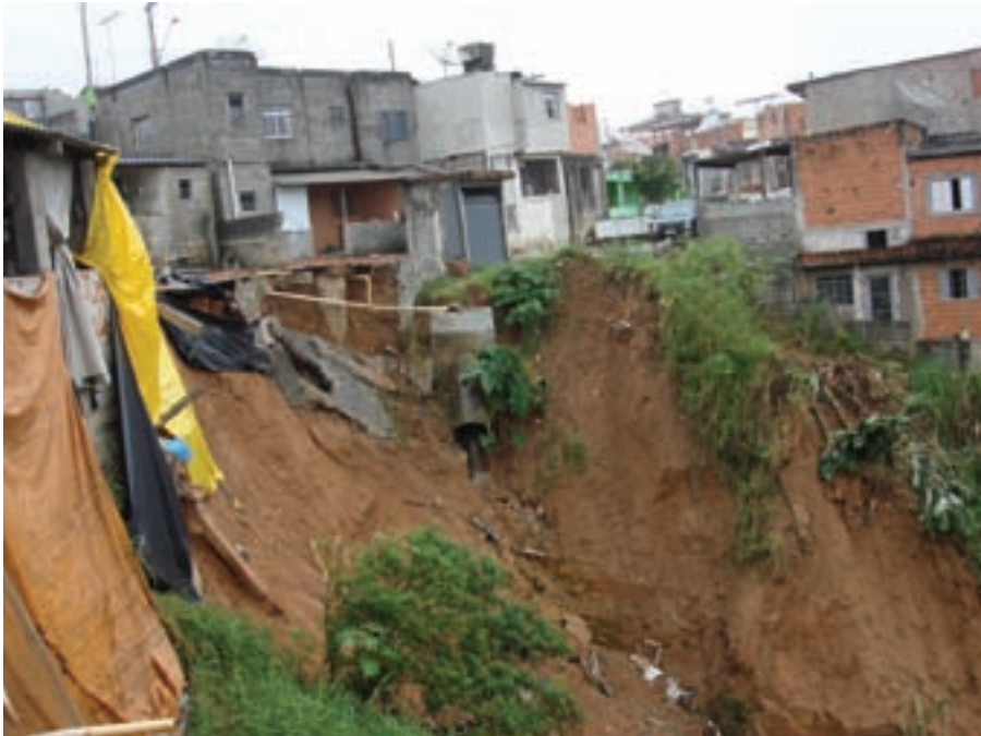
Escorregamento induzido por despejo de tubulação de água pluvial em Franco da Rocha (Janeiro de 2010). Foto: Acervo IG.
