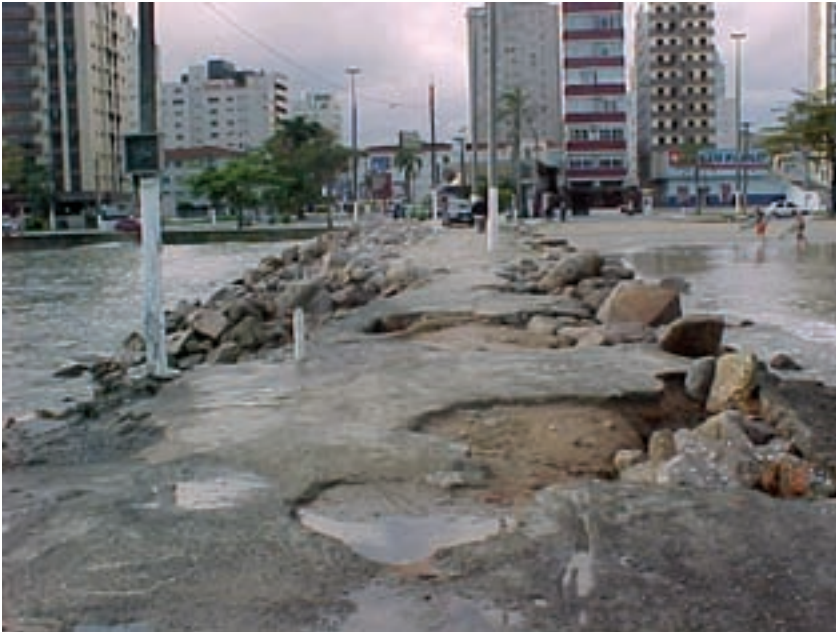
Erosão costeira em praias e construções em Santos (2006). Foto: Acervo IG.
