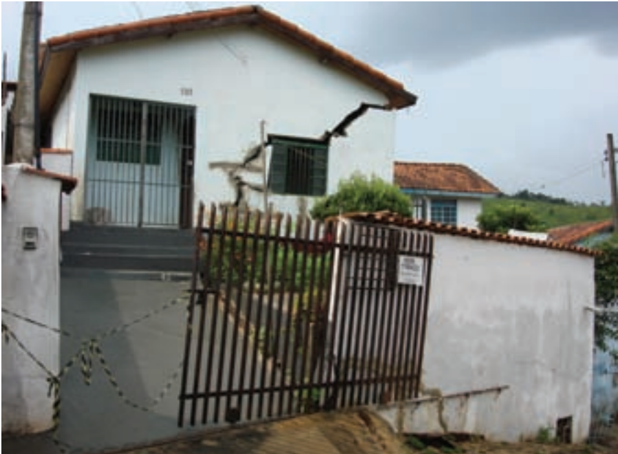
Trincas em moradia provocadas por subsidência de solo em terreno cárstico em Guapiara (Fevereiro de 2010). Foto: Acervo IG.
