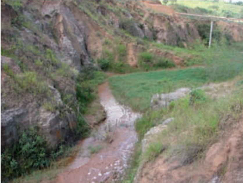
Afloramento do lençol freático na área interna da boçoroca. Quando o processo erosivo atinge este estágio, torna-se mais difícil o seu controle e estabilização. São Pedro (Abril de 2007). Foto: Acervo IG.
