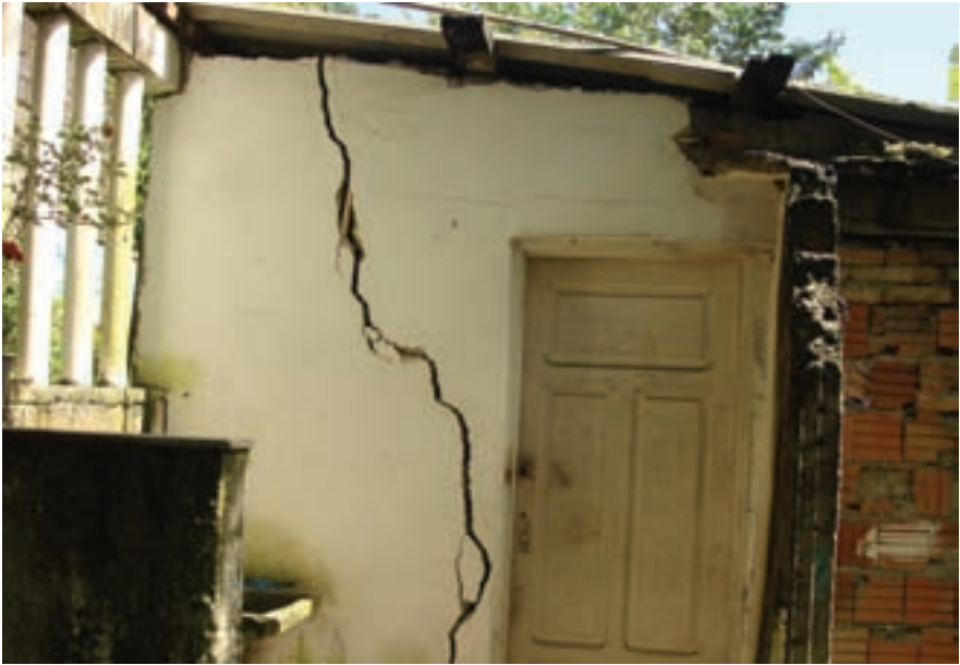
Trinca em moradia em São Vicente (Abril de 2010). Foto: Acervo IG.
