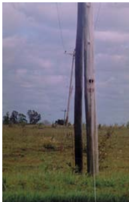
Foto 151 - Desalinhamento de postes em área de solos com argila expansiva. Uruguaiana – RS. Sérgio Hideiti Shimizu
