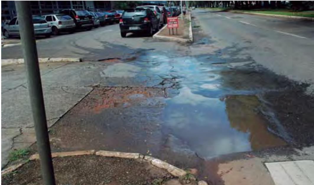
Presença de obstáculos sobre as calçadas. Brasília/DF. 2013. Foto: Fátima Macedo.
