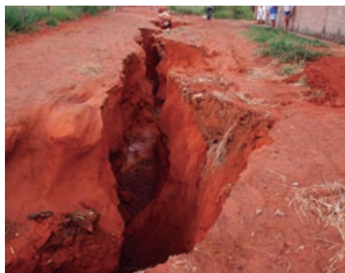
Imagem ilustrativa de uma Erosão.
