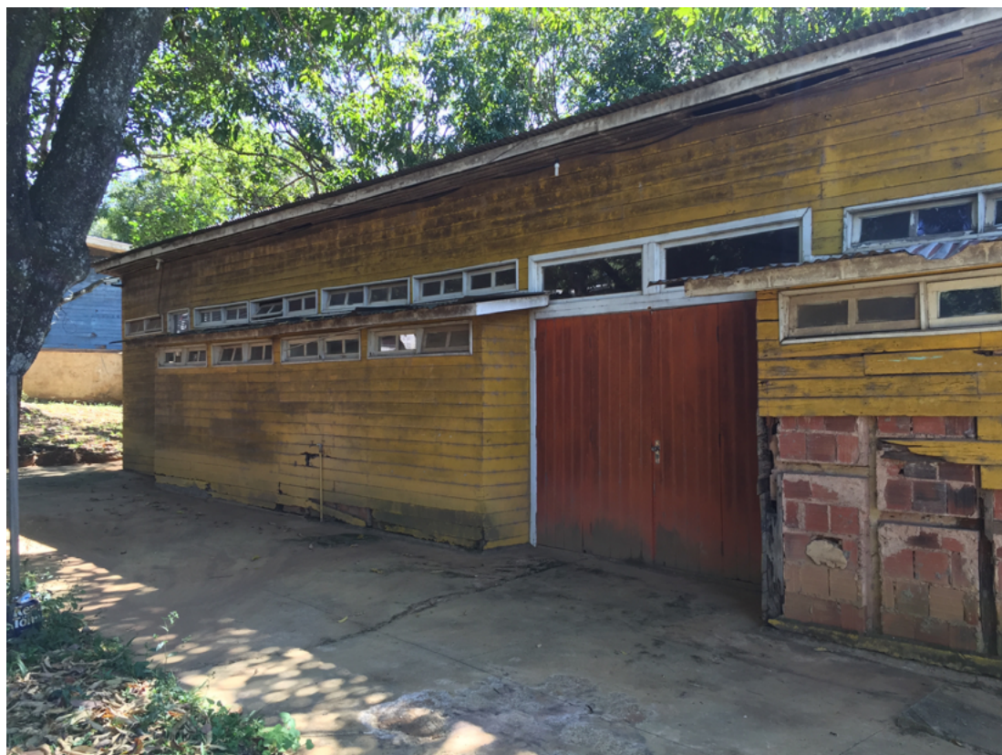
3 MVMC: fachada sudoeste – Alojamento Feminino (Solteiras), atual Oficina de Madeira. Edificação em mau estado geral de conservação, com introdução de materiais novos (alvenaria de tijolos)
