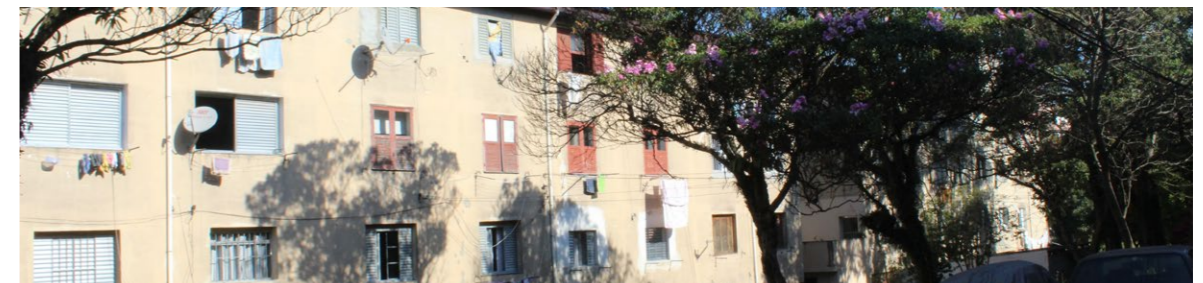
Figura 116: vista parcial da fachada posterior em que é possível observar a multiplicidade de tipos de esquadrias que se diferem, até mesmo, na mesma unidade habitacional.
