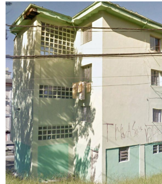
Figura 99: fundos da caixa de escada com obstrução de alguns vão de iluminação.
