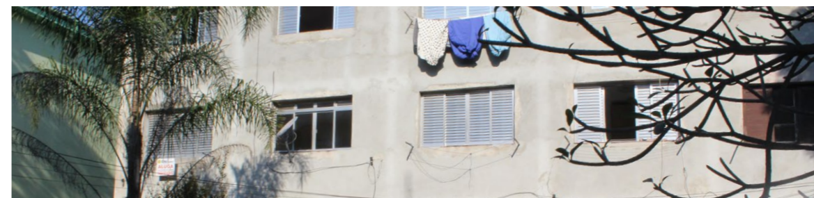
Figura 94: vista parcial da fachada posterior em que se nota a presença de janelas de diversos tipos e materiais.
