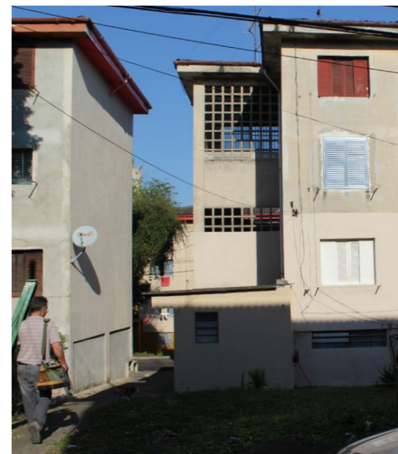
Figura 103: anexo construído nos fundos da caixa de escada cuja estrutura de iluminação está parcialmente vedada e sem vidros
