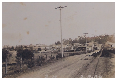
07. Foto em que se vê escavações relativas à obra de canalização de água realizada pela prefeitura.
