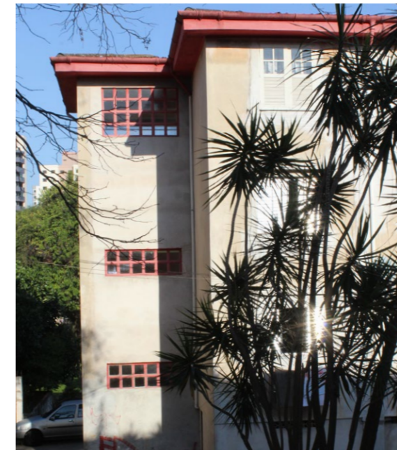
Figura 106: fundos da caixa de escada com obstrução de grande parte da estrutura de iluminação.
