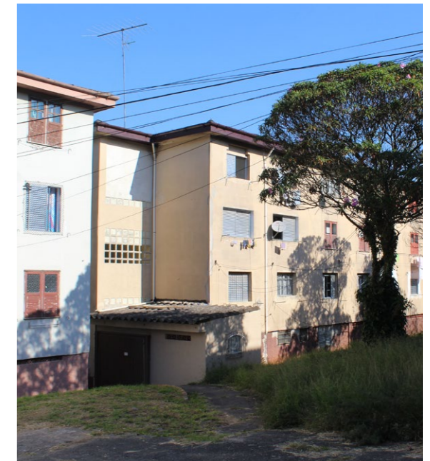
Figura 115: vista parcial da fachada posterior e do anexo construído nos fundos da caixa de escada.
