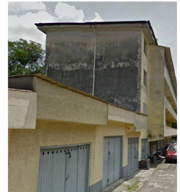
Figura 83: vista dos anexos e da lateral, obstruída, dos corredores de acesso aos apartamentos.
